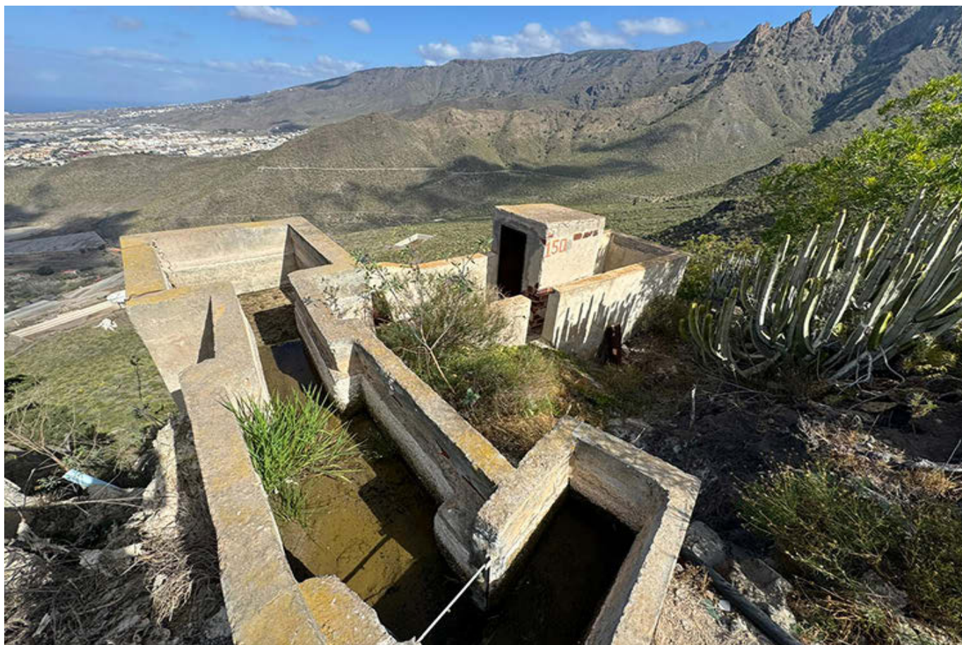
Punto de medición 150 del Canal del Sur. eE
