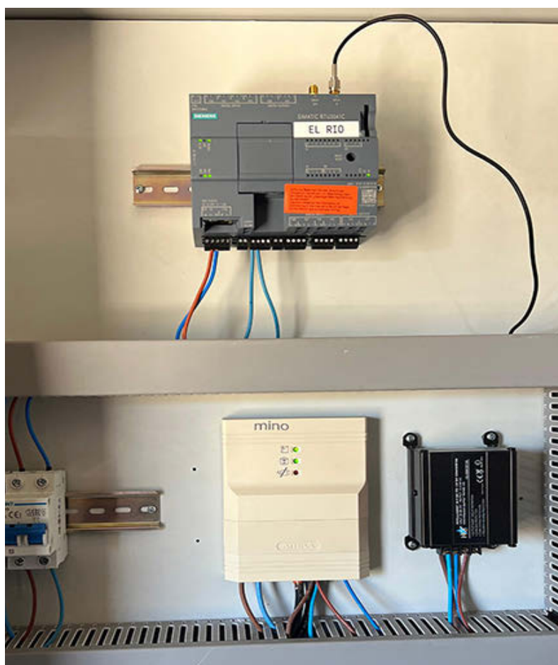
Estación remota de telecontrol alimentada por una placa fotovoltaica. eE
